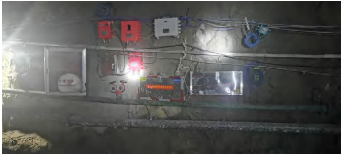
井下供风、供水、监测监控及消防设施
