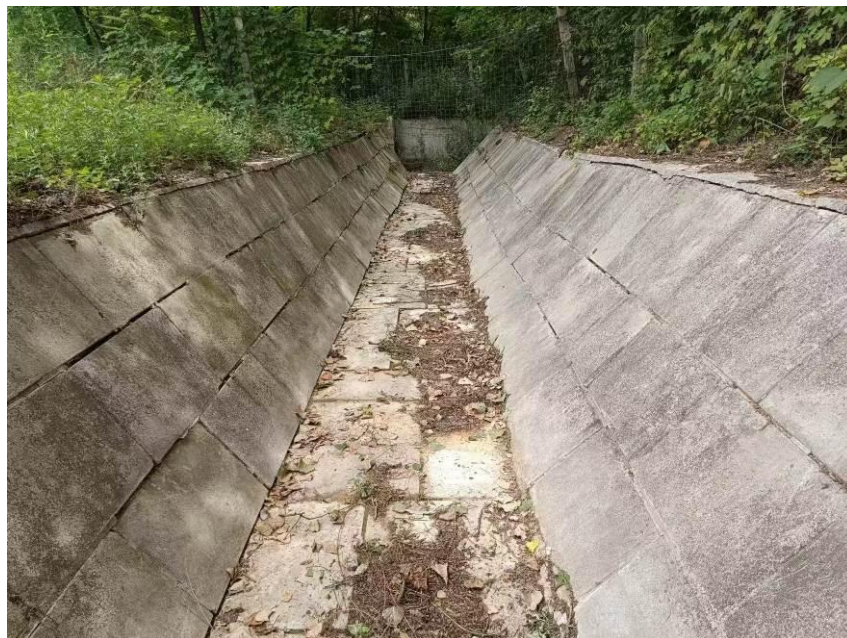
照片 1 坝肩沟修复前
