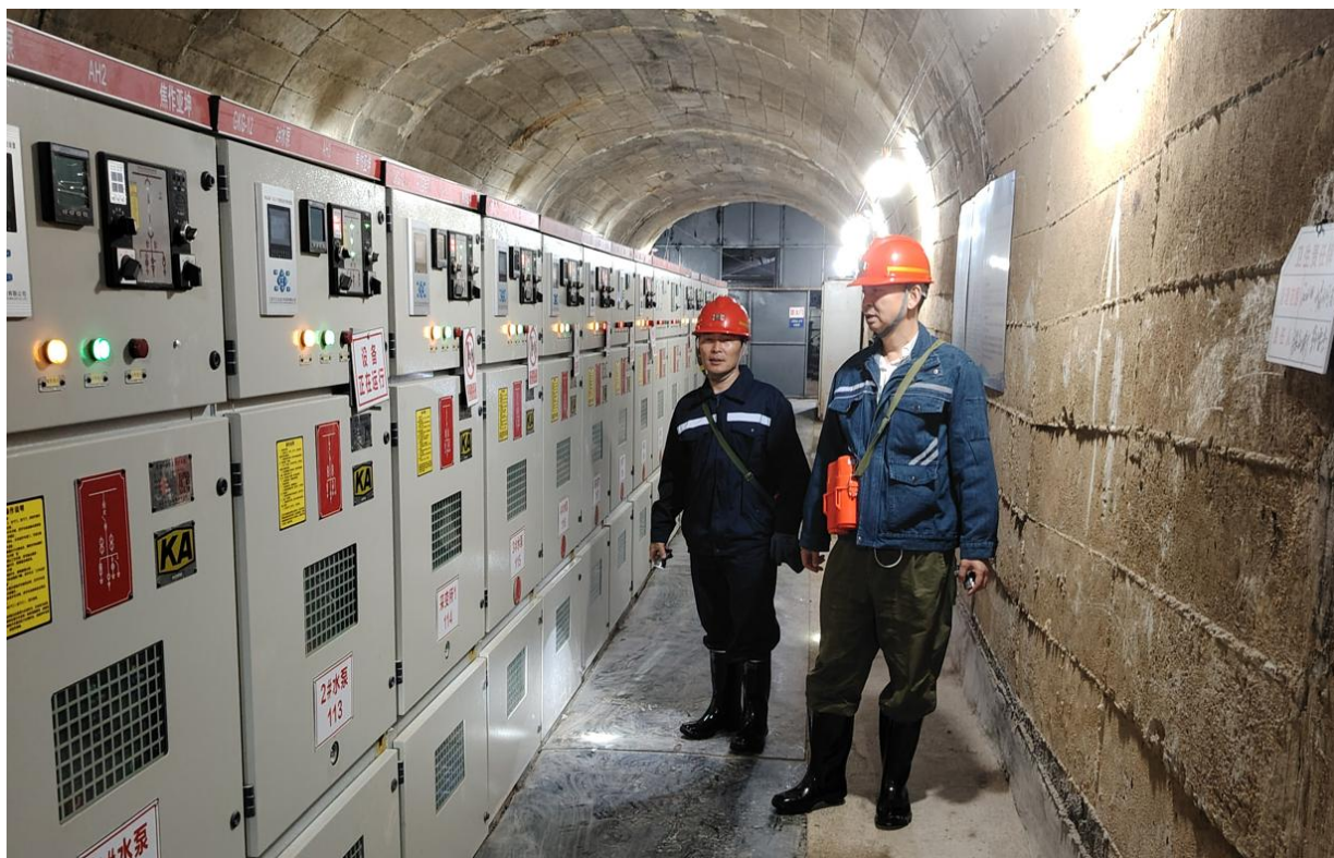
井下中央变电所
