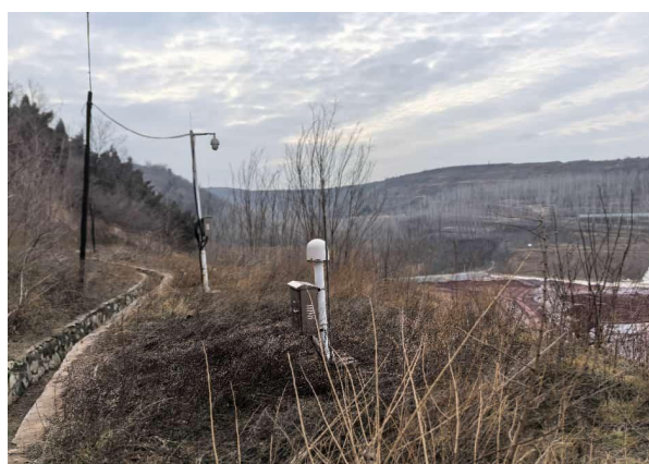
照片 21 GPS 基站
