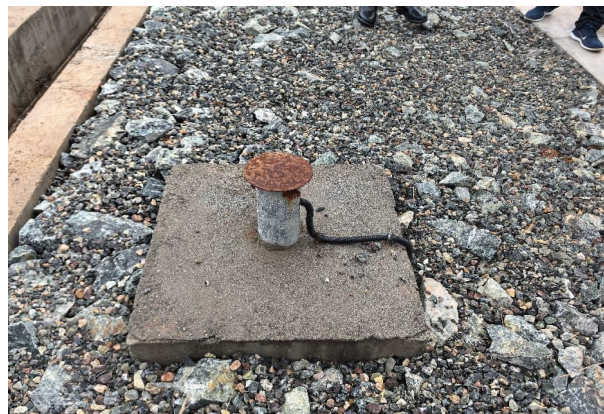
照片 28 浸润线在线监测
