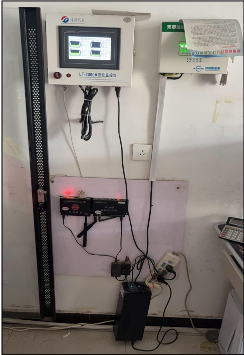
液位仪和渗漏检测仪已配备 UPS 电源
