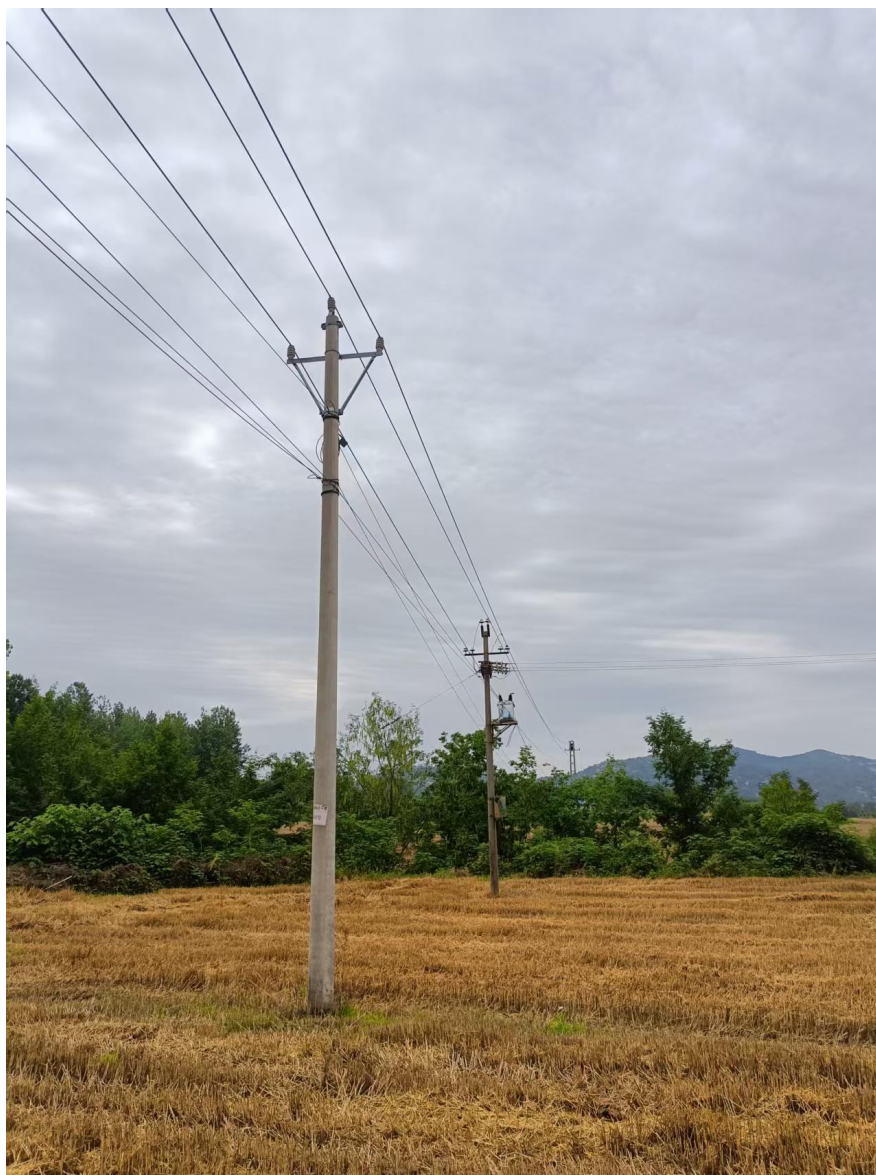
图 2.1-4 矿区东侧 10KV 史林主干线高压输电线路
