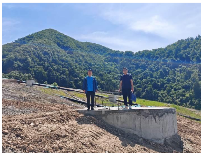
照片 2 2#大口辐射井
