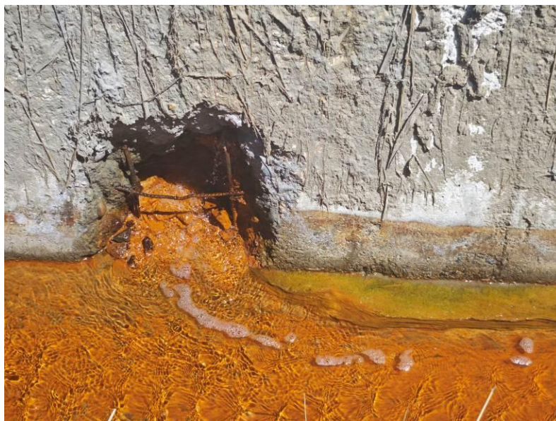
照片 1 初期坝下渗水
