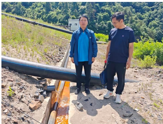
照片 3 2#大口辐射井渗水
